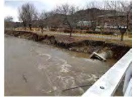
いわき市ホタル水路脇河川の被害状況
