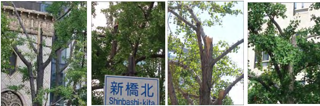
写真 24～27 イチョウ街路樹の芯折れ状況
